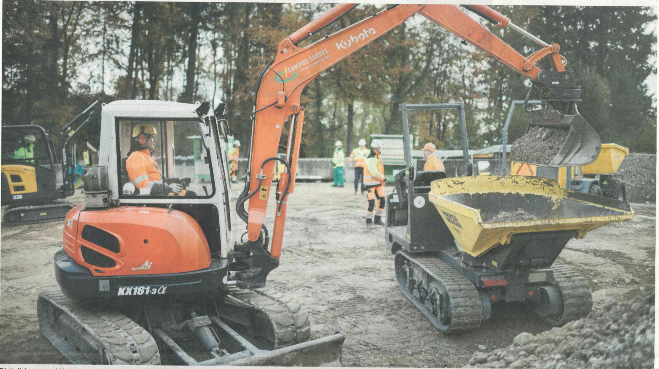
Digitalisierung und Mechanisierung haben die körperliche Arbeit auf dem Bau reduziert. Dadurch könnten auch Frauen Karriere in der Baubranche machen, ist Thomas Stocker, Geschäftsführer des Bildungszentrums Bau des Campus Sursee, überzeugt. FOTOS ZVG
